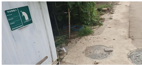
废水总排放口
