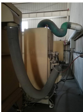
图 1 喷砂机与滤筒除尘器连接处
