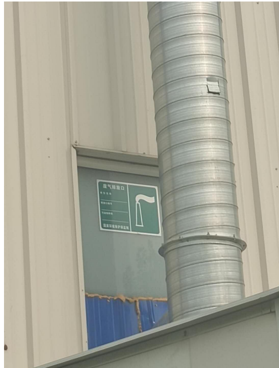
P1 排气筒标识牌
