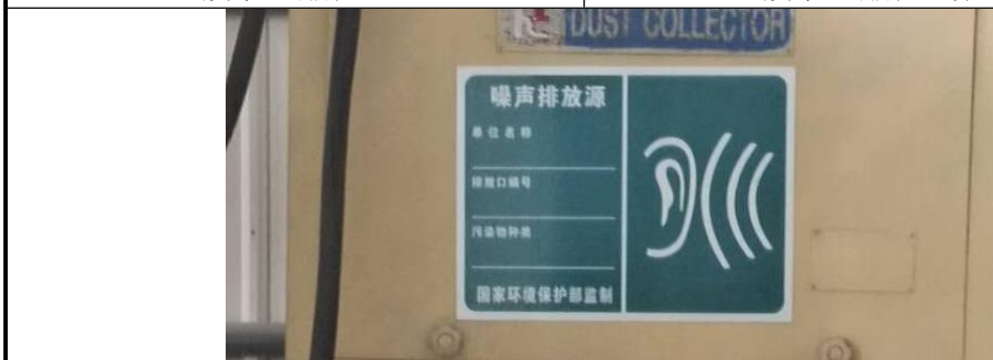
噪声排放源处标识牌
